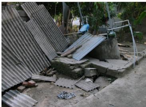
Gambar 6 Likuifaksi Akibat Kejadin Gempa Lombok Utara Tanggal 5 Agustus 2018 Mengakibatkan Kerusaka Trumah Penduduk Dan Smur Menjadi Miring di Dusun Beraringan, Desa Kayangan, Kecamatan Kayangan, Kabupaten Lombok Utara (Sumber: Tim Pusat Studi Gempa Nasional., 2018)
